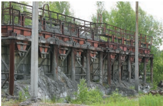
7.20. fotó. A betonáttöltő állomás a szarkofág építése során a „tisztá” és a „szennyezett” terület határa volt
